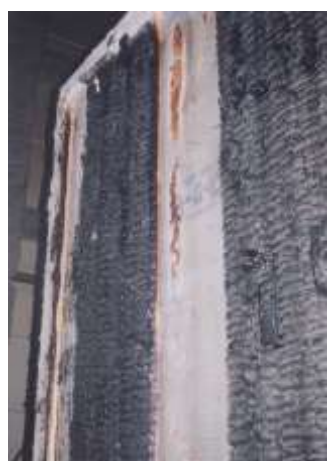
サイディング下 / 防水紙が熱で損傷
