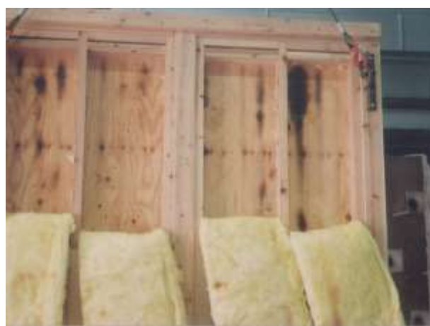
壁内部 / 壁内部へのほ炎貫通無し
