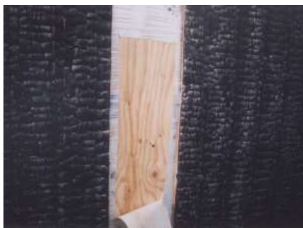
サイディング下 / 燃焼による損傷無し
